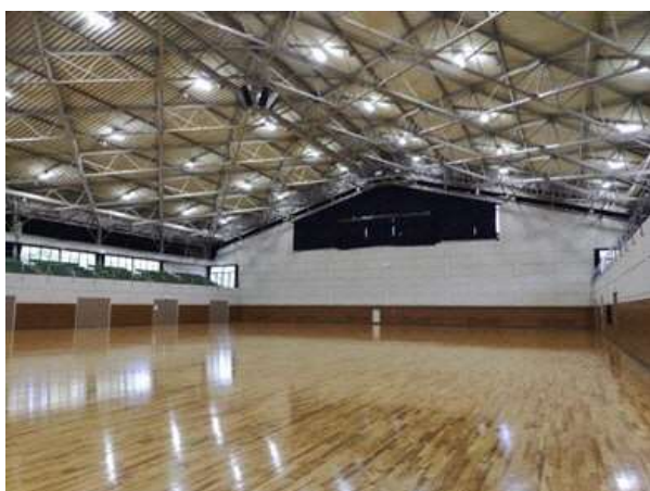
LED 照明設備（総合運動公園体育館）
