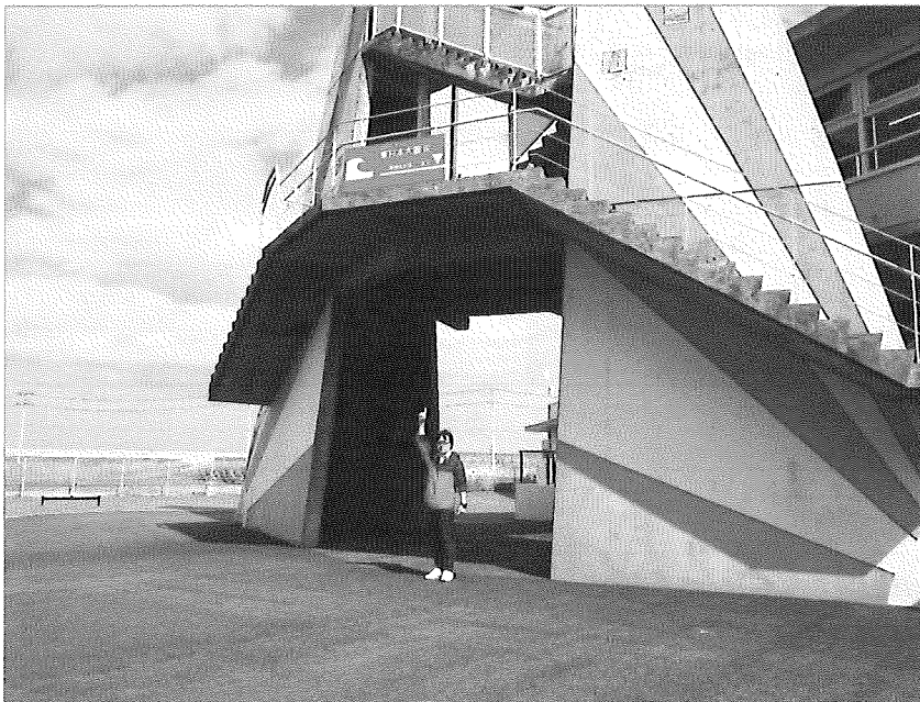
津波は青い看板の高さまで到達した。暫定津波高 15.5m
