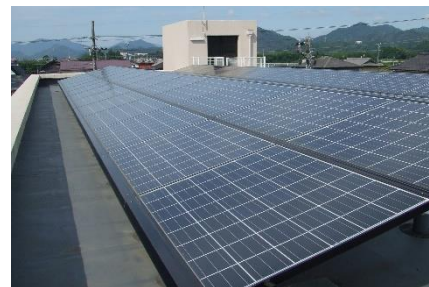
写真 綾部会館の屋根に設置された太陽光発電設備 出所：綾部市撮影
