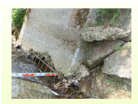
下部工の変状
