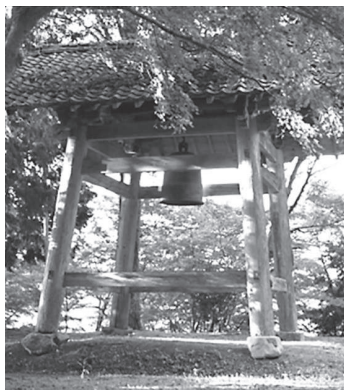
▲老朽化が進み倒壊が危ぶまれていた改修前の鐘撞堂と風雪でひび割れ、20年以上使用されていなかった鐘
