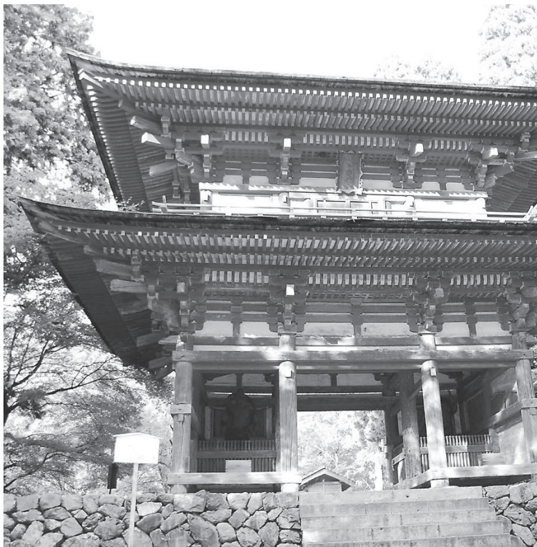
▶屋根の全面葺き替えて当時の重厚な屋根が蘇る。再塗装された、建立当時の美しいベンガラ塗りの色彩は現場で確認を（写真は修復前）
