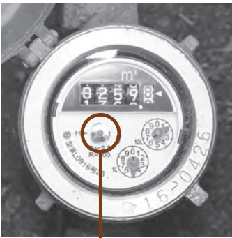
漏水はパイロットマークで確認
