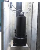
ポンプの口径は500ミリ。雨水を素早くくみ上げ、由良川に流します
