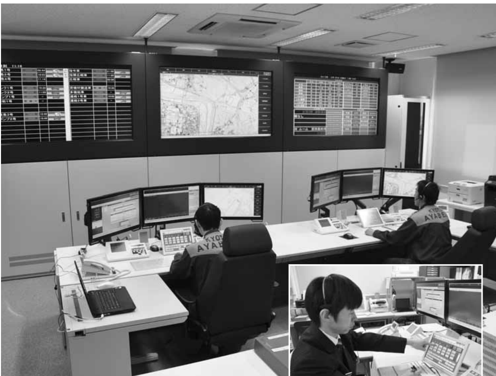
情報の収集能力が強化された消防通信指令室
